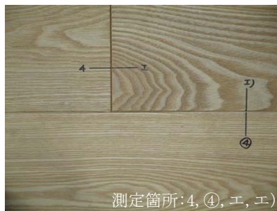
写真 5 試験終了時の状況（一般部）（アッシュ 20 クリアオイルロング）
